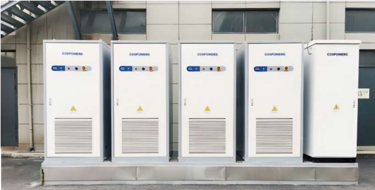
Proyecto de Almacenamiento de Energía Comercial e Industrial de la Fábrica de Lavado de Ropa de Taixing,
