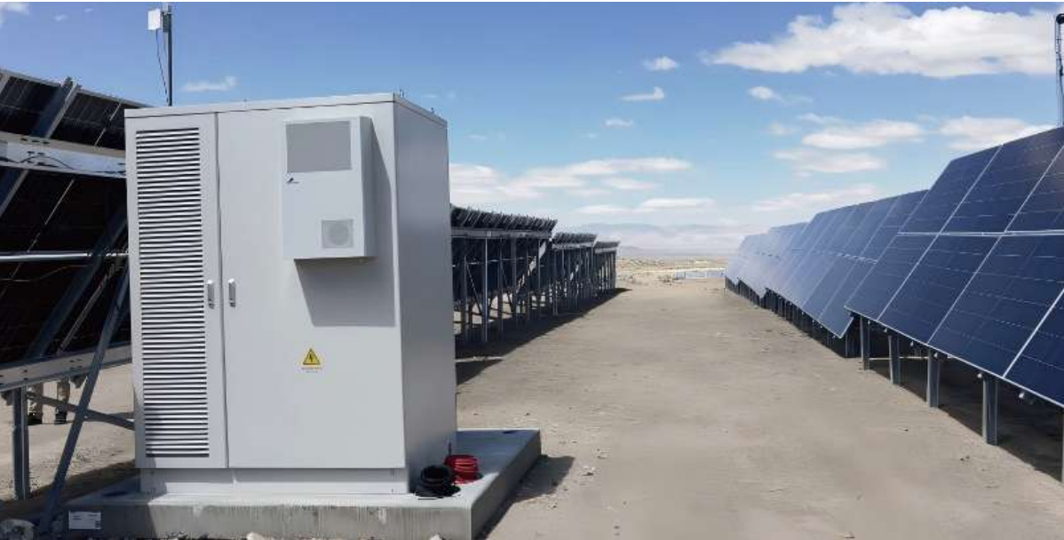
Proyecto de Energía Solar-Storage Integrado Fuera de la Red de EE. UU.
