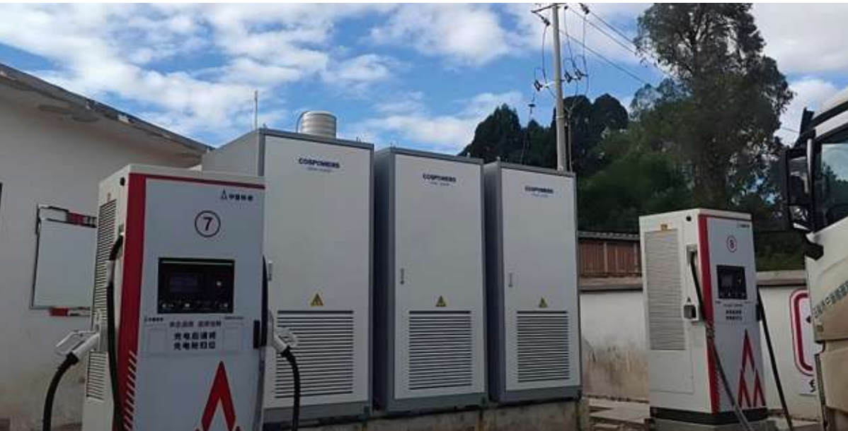
Proyecto de Almacenamiento de Energía de la Estación de Carga de Camiones Pesados de la Aldea Beida de
