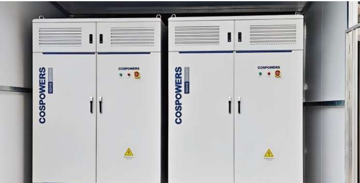
Proyecto de Almacenamiento de Energía Comercial e Industrial de Shenzhen Pinghu Reducción de Picos y Llenado de Valles Tiempo del Proyecto: 2024 Ubicación del Proyecto: Guangdong,China
