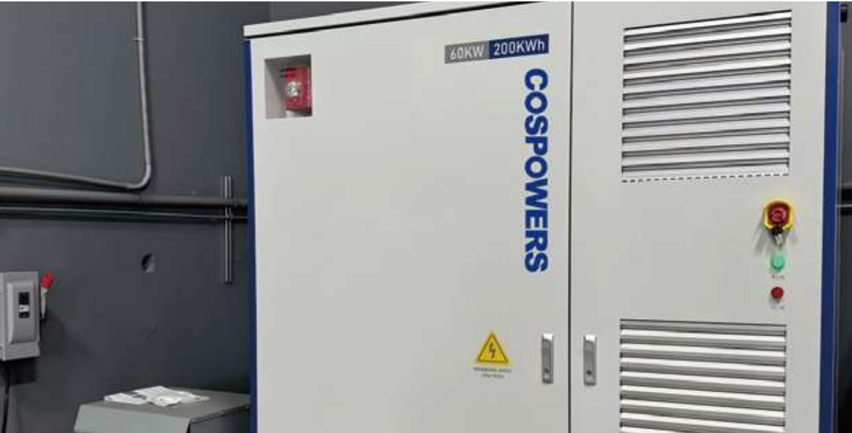
Almacenamiento de Energía Comercial e Industrial de EE. UU. Tiempo del Proyecto: 2025 Ubicación del Proyecto: San Francisco, EE. UU.
