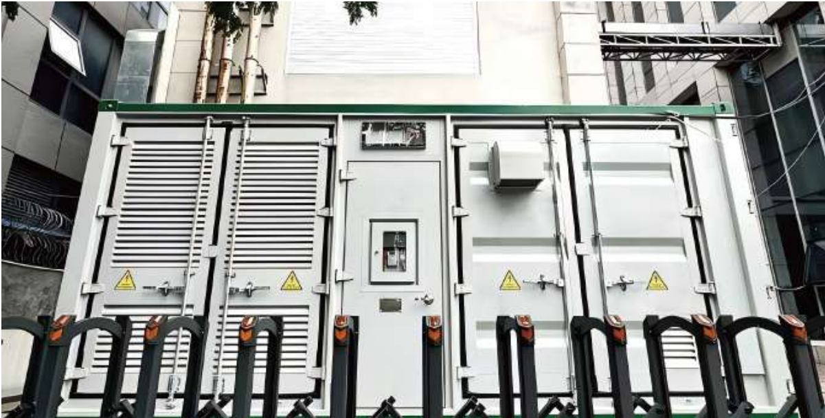
Proyecto de Almacenamiento de Energía Comercial e Industrial de Myanmar
