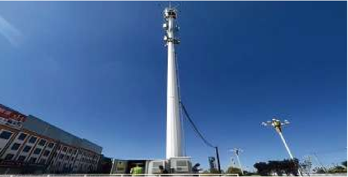
Proyecto de batería de sodio inteligente de China Tower Gansu Tiempo del proyecto: 2024 Ubicación del proyecto: Tianshui,Gansu, China
